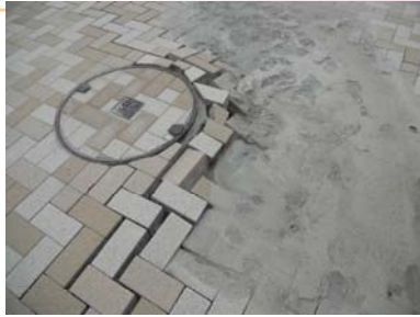
まだ下水が復旧していない
